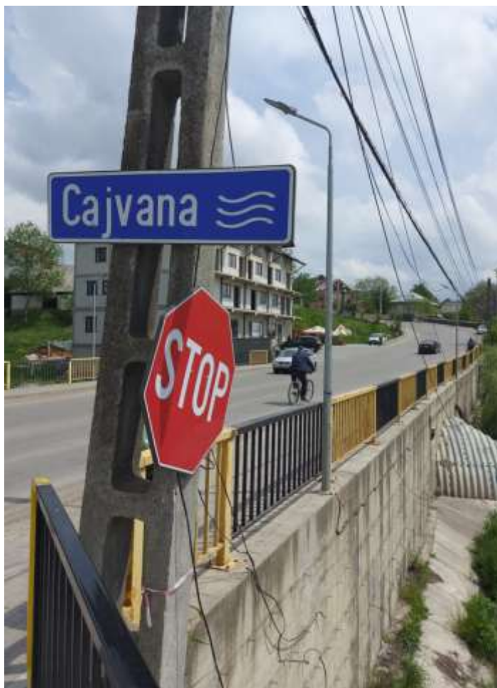
Figura 35 – Exemplu de amplasare necorespunzătoare a indicatorului B2 - Oprise
